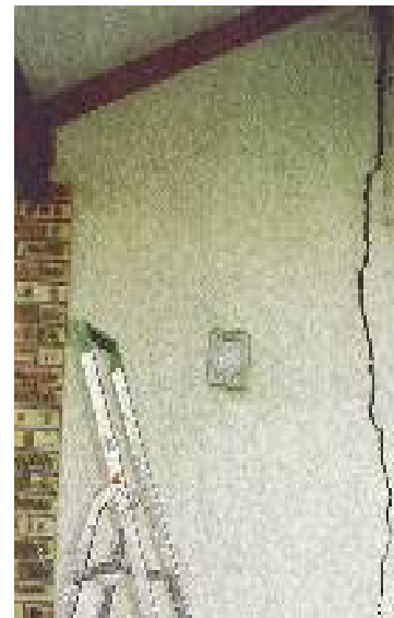
Fissuration des murs d'une maison suite à la sécheresse de 2003
