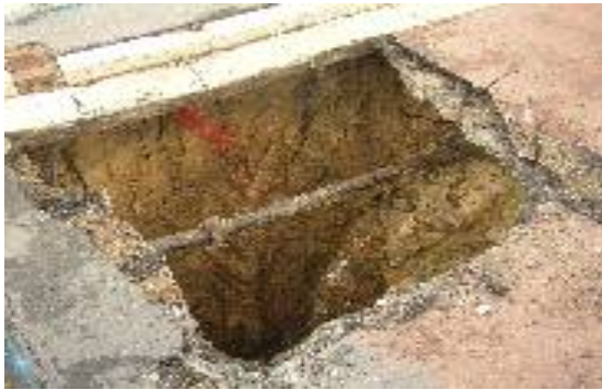
Dissolution du gypse sous une fuite du réseau d'eau potable créant un vide puis un effondrement de type fontis, Argenteuil, 2003 – source : IGC
