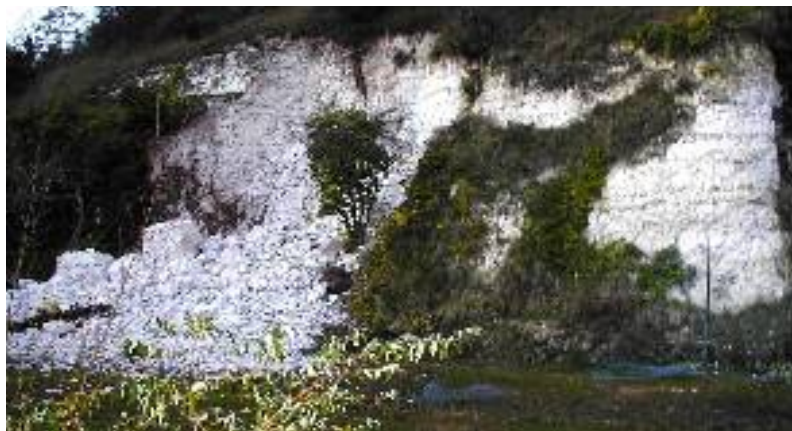
Eboulement de falaise à La Roche-Guyon en 2001 – source : IGC
