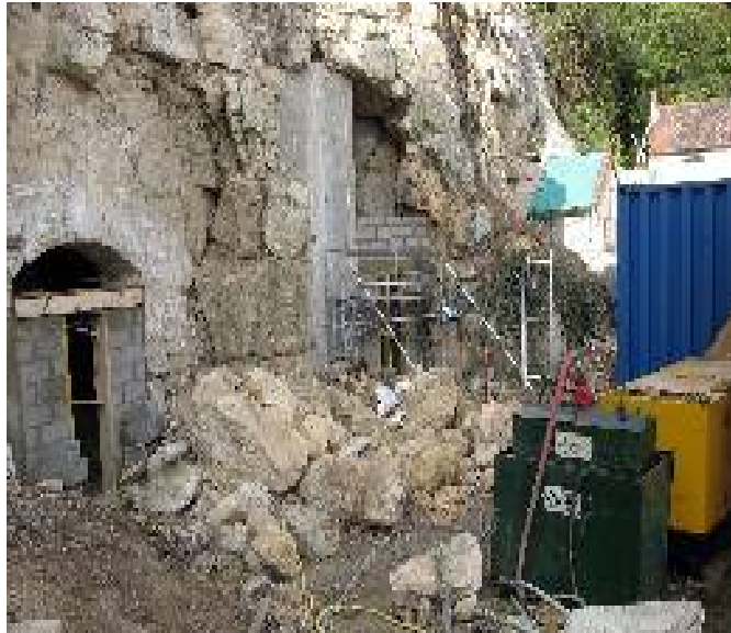
Travaux de confortement d'une falaise sous-minée par une carrière à Chars en 2007 – source : DDEA
